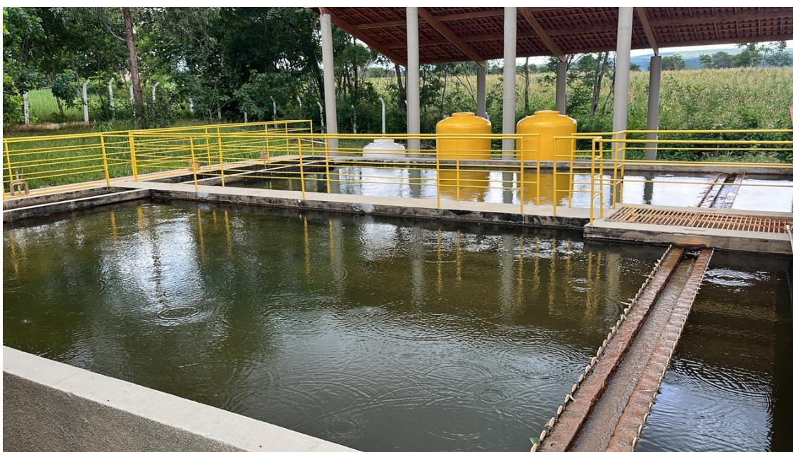
Figura 24: Tanques de floculação/decantação da ETA.
