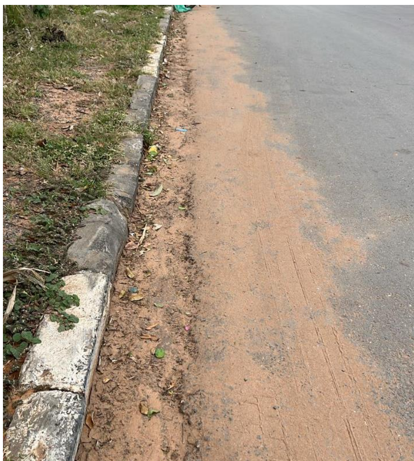
Figura 30: Sarjeta com acúmulo de sedimentos.
