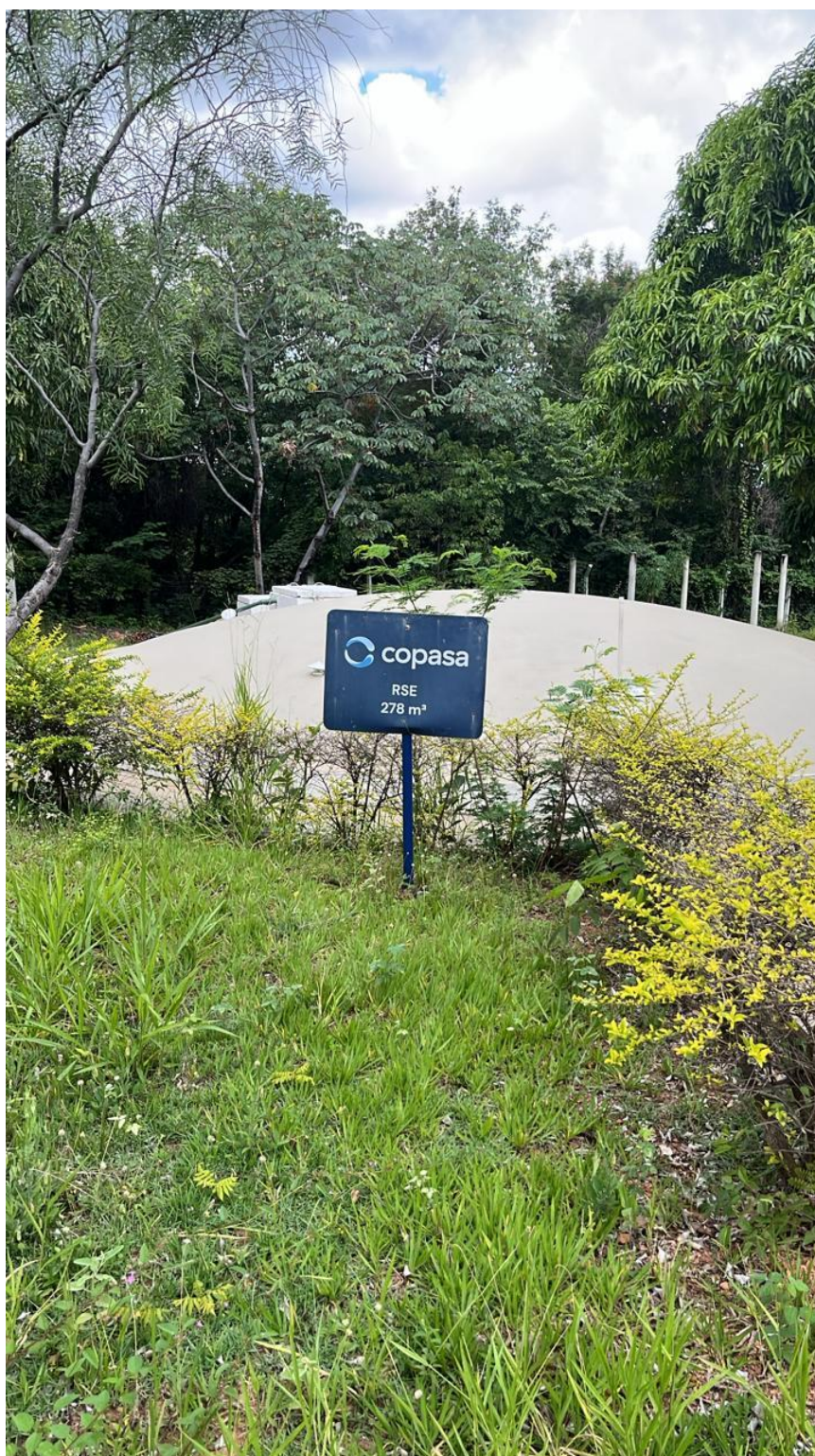
Figura 26: Reservatório de água do Município de Jequitaiá.
